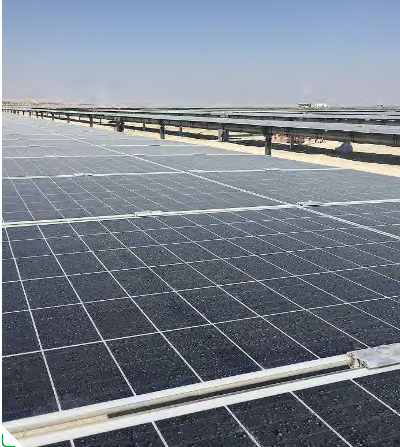
► Konya Karapınar Ges Projesi, Scada binası tüm mekanik imalatları ve mühendislik hesaplarının yapılması.
